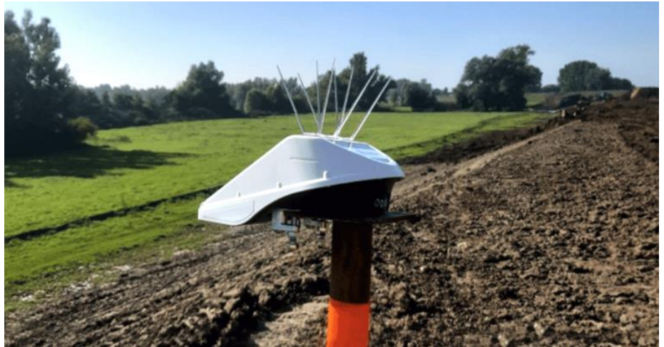
Capteur Locator One sécurisé sur une colonne montante de plaque de tassement et protégé par des pics anti-oiseaux
